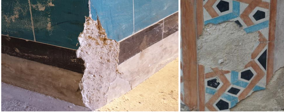
Resim 48. Sahip Ata Türbe, onarımlardan sonra görülen parça kaybı (Solda).
