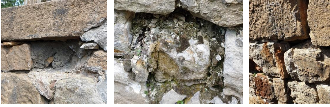
Resim 3. Kastamonu Adil Bey Türbesi, taşıyıcı duvarda birim malzeme kaybı (Solda).
