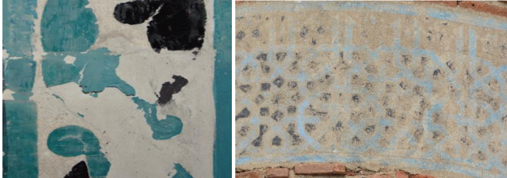
Resim 45. Konya Sahip Ata Cami, onarımlardan sonra görülen yüzey boya kabarması (Solda).
