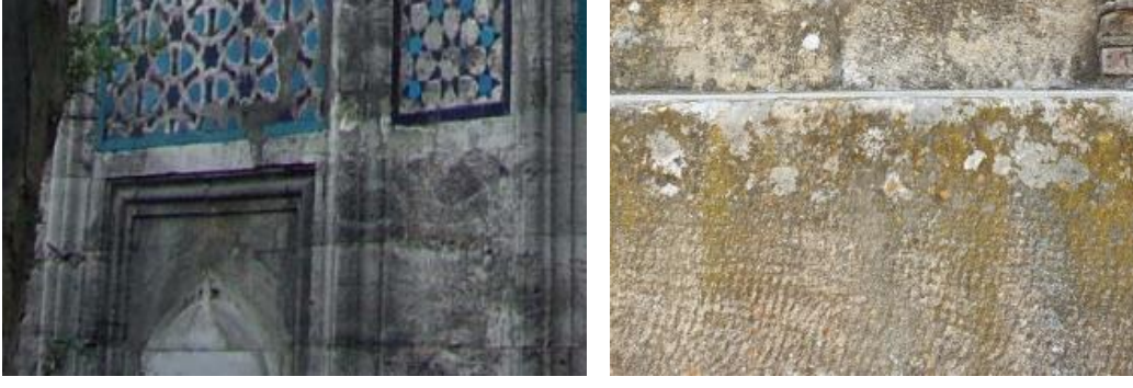
Resim 7. İstanbul Mahmut Paşa Türbesi, taşıyıcı duvarlarda yüzeysel kirlilik (Solda) (Taşkiran, 2014: 76).
