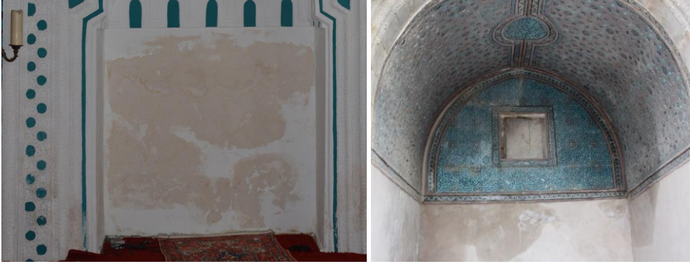
Resim 39. Konya Tahir ile Zühre Mescidi, onarımlardan sonra görülen nem (Solda).
