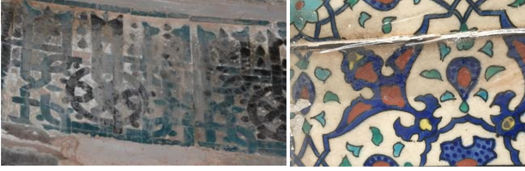
Resim 33. Akşehir Taş Mescit, onarıma ait leke-kirlilik (Solda).
